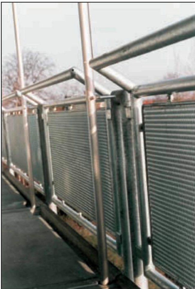
Varmforzinkede altanrækværker i højhusbyggeri.
